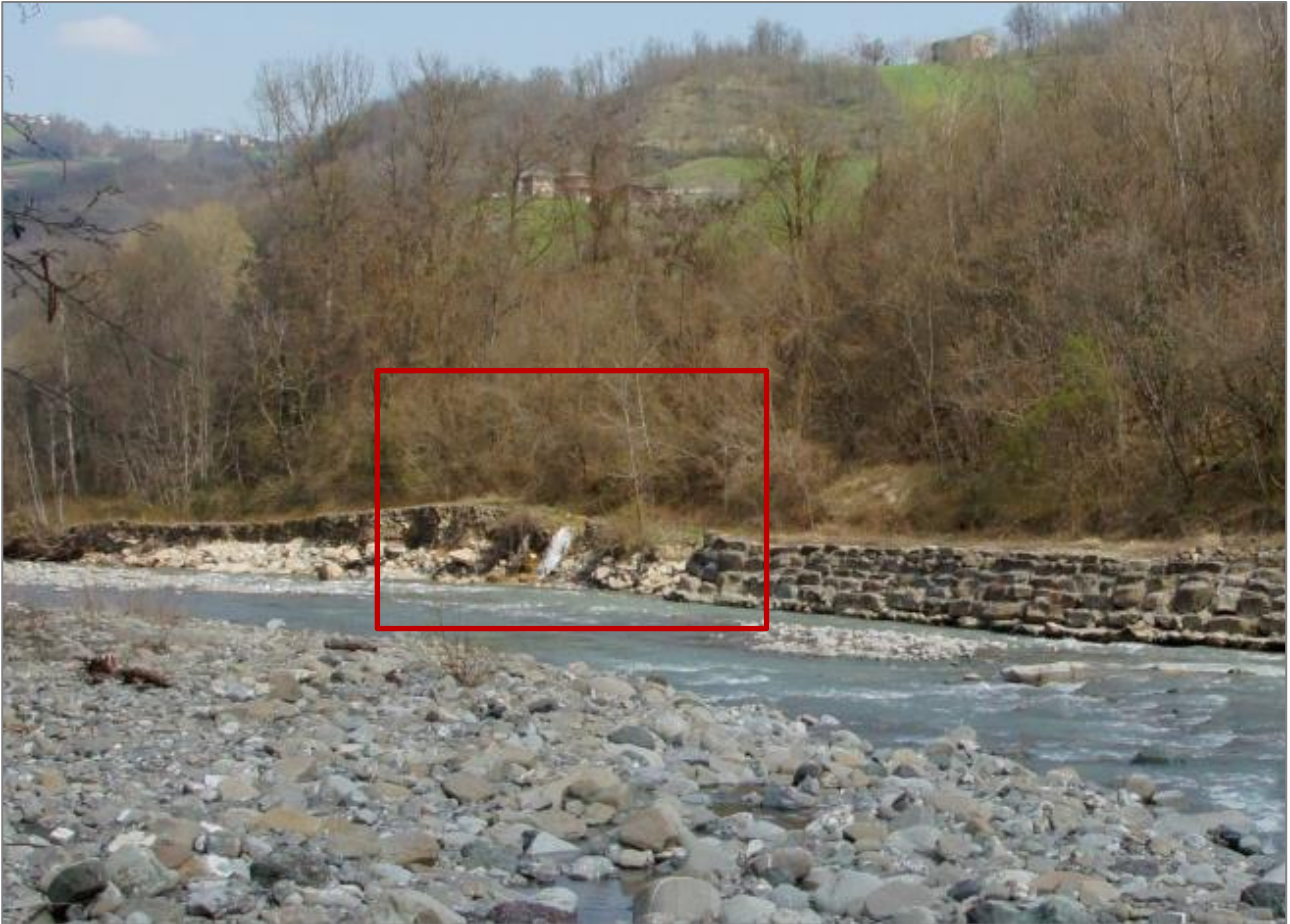
Fig. 2.6 – Ripresa laterale della sponda destra del T. Dragone, è ben visibile il muro a protezione della sponda e il rio affluente posto dopo la fine del muro individuato dal riquadro rosso
