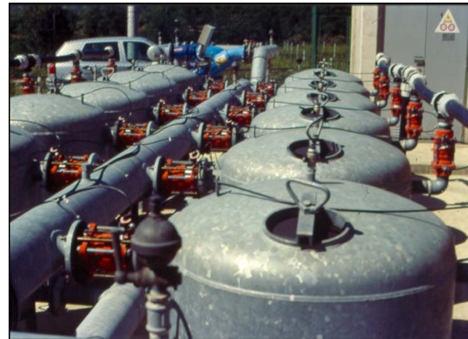
La stazione di filtraggio
