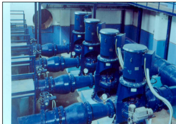
La stazione di pompaggio
